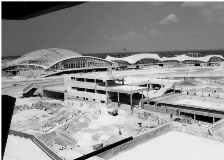
Wojciech Zabłocki (architektura), we współpracy z Henrykiem Rollerem (urbanistyka), Andrzejem Rybą (stadion) i Jackiem Kwiecińskim (zespół basenów): ośrodek olimpijski w Latakii podczas budowy (Syria, 1987). Zdjęcie z archiwum Jacka Kwiecińskiego, lata 80.
